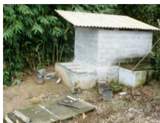
连接有甲烷坑的砖墙泥地铁顶厕所
